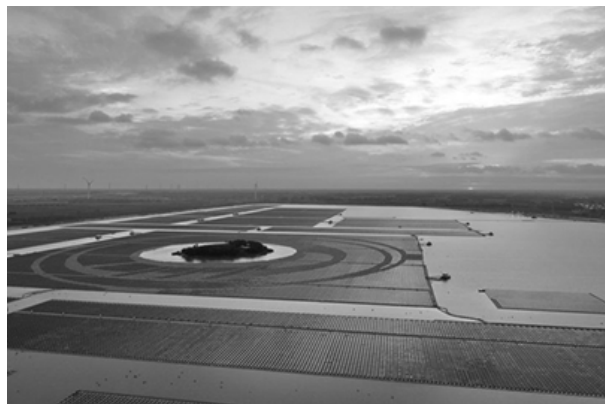
Плавучая электростанция Dezhou Dingzhuang
